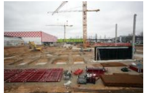
Wiesbadens größtes Loch: An der Äppelallee wird schon an den Fundamenten des neuen XXXL-Möbelmarkts gearbeitet.
